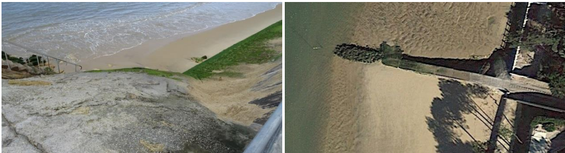
Figure 74. Exemple d'enracinement de l'épi au perré au niveau de l'avenue des Merles (source : CASAGEC - Google Earth 2016).
