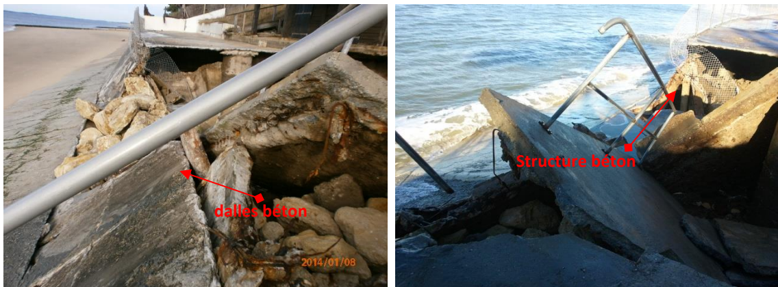
Figure 60. Clichés de la rupture du perré des Fauvettes (source : Commune - 8/1/2014).
