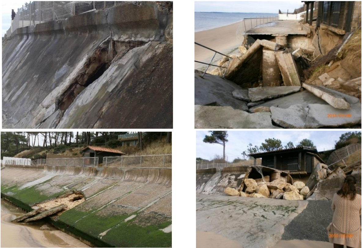
Figure 59. Dégâts engendrés sur les perrés par les tempêtes de l'hiver 2013-2014 (Source : Commune de la Teste de Buch).
